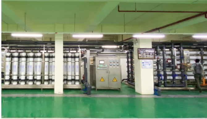
越南百和(台商) - 印染廢水 1,000噸產水回收/天 - 染缸用水
