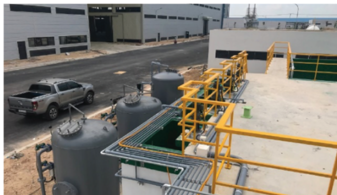
越南台湯電池(台商) 500噸/天 - B級排放 CÔNG TY TNHH TAITAN VIỆT NAM (ĐÀI LOAN), Công suất xử lý 500m 3 /ngày, tiêu chuẩn B xả thải
