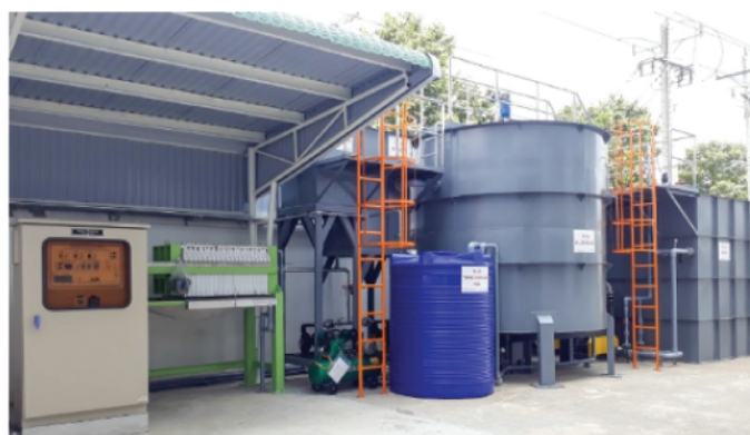
楊成木業家具一、二期(台商) 噴塗廢水200噸/天 - A級排放 CÔNG TY TNHH QUỐC TẾ CÔNG NGHIỆP GỖ YANG CHENG VIỆT NAM (ĐÀI LOAN) giai đoạn 1,2. Nước thải phun sơn 200m 3 /ngày, tiêu chuẩn A xả thải
